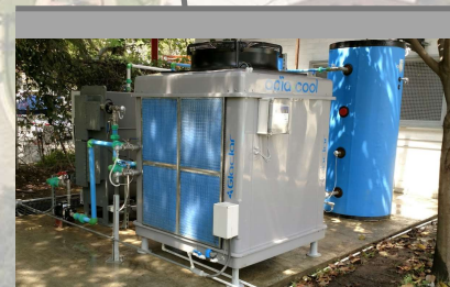
Climatización solar LiBr/Agua
