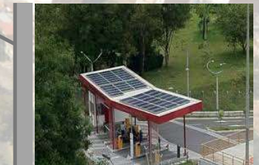
Sistema solar fotovoltaico de 25 kWp
